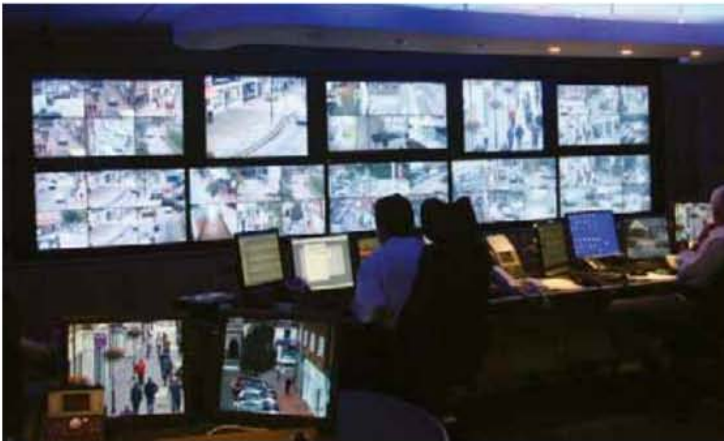
Otelerde etkin bir şekilde kullanılan CCTV sistemleri hem işletme verimliliğine hem de can ve mal güvenliğine önemli katkılar sağlar.
